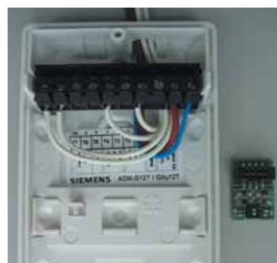
Typowe proste okablowanie czujek E-Line
